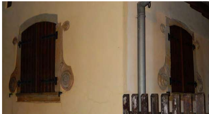
30, rue d'Oberhergheim : 2 encadrements en bon état, et 2 encadrements avec des parties récupérées.
