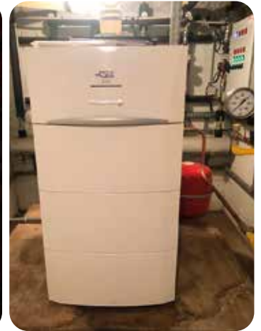
Nouvelle chaudière à l'école primaire
